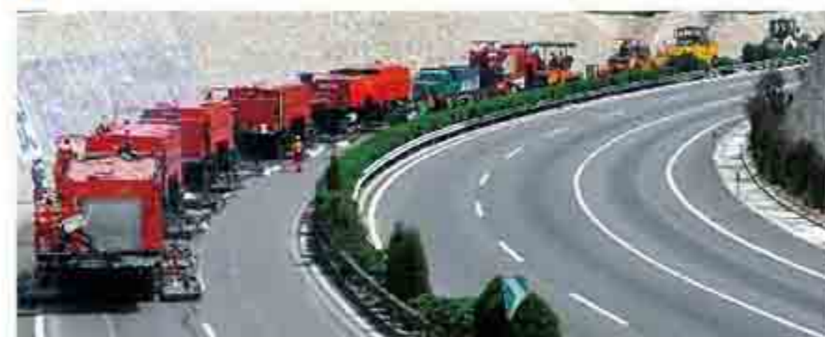
英达热再生机组的施工现场图
